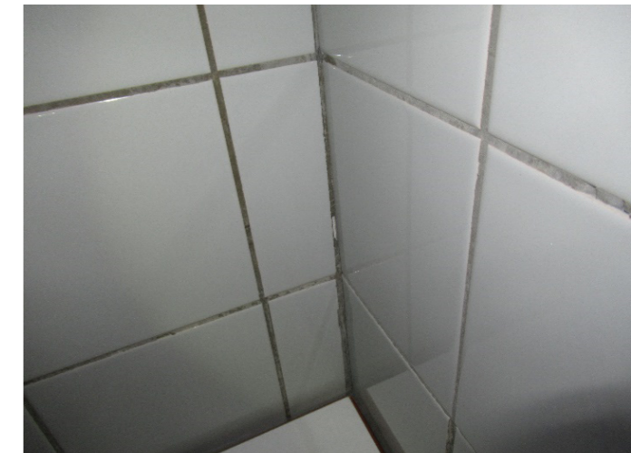
Eksempel på manglende / porøse flisefuger.
