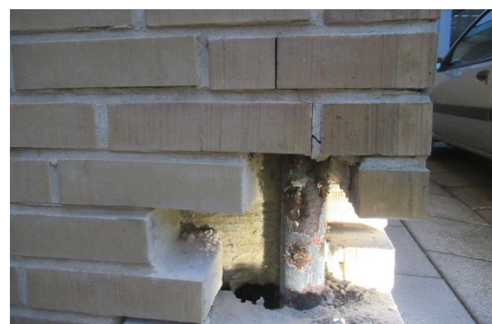
Eksempel på korrosion af bærende stålsøjler.
