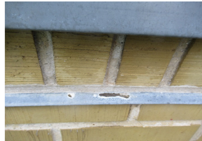
Eksempel på korroderet indskud under sålbænk
