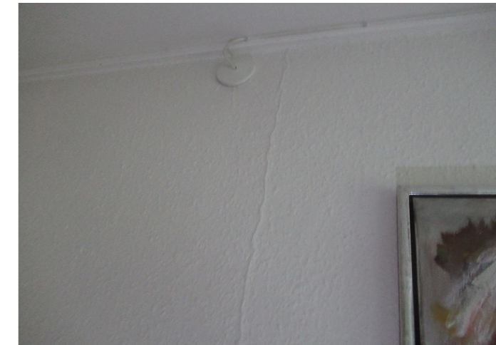
Eksempel på skillevægge med revnedannelse.
