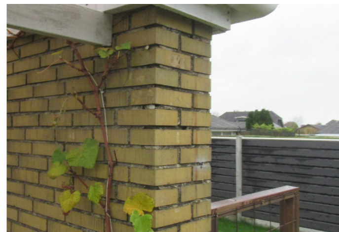
Eksempel på nedbrydning af fuger i murværket.
