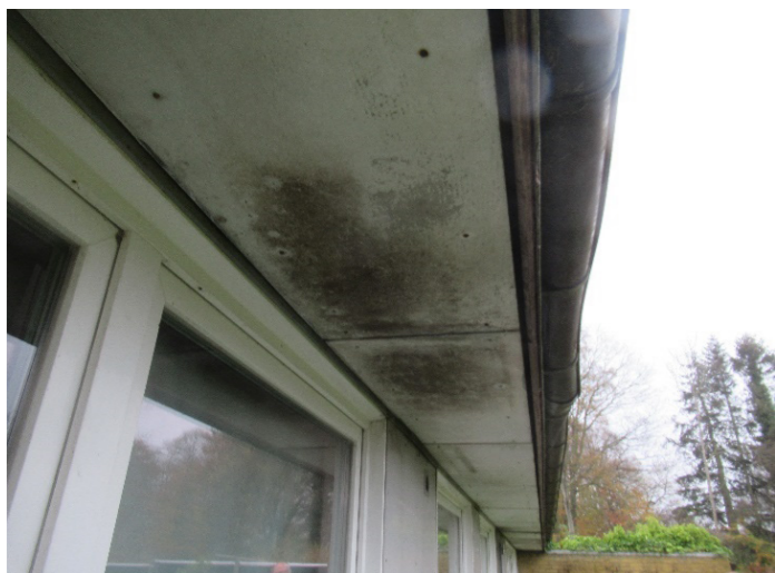
Eksempel på fugtplamager på underbeklædning og beskadiget tagrende.
