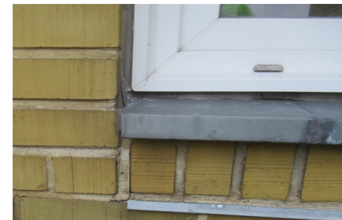
Eksempel på fugeslip i kalfatringsfuge.
