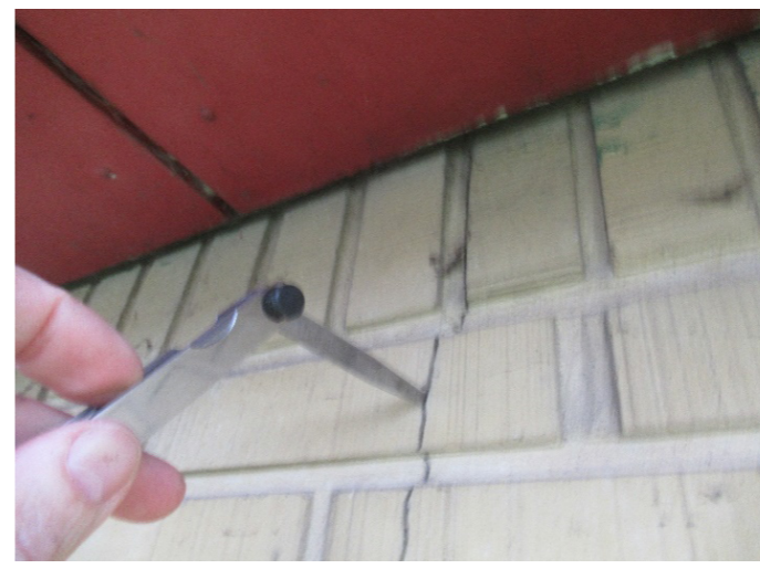
Eksempel på revnedannelse i facade.
