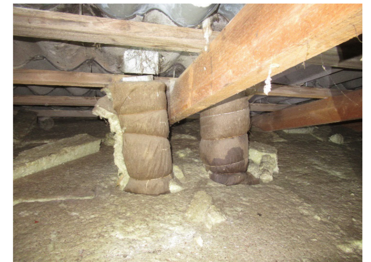
Eksempel på utæt aftrækskanal og manglende kondensisolering.
