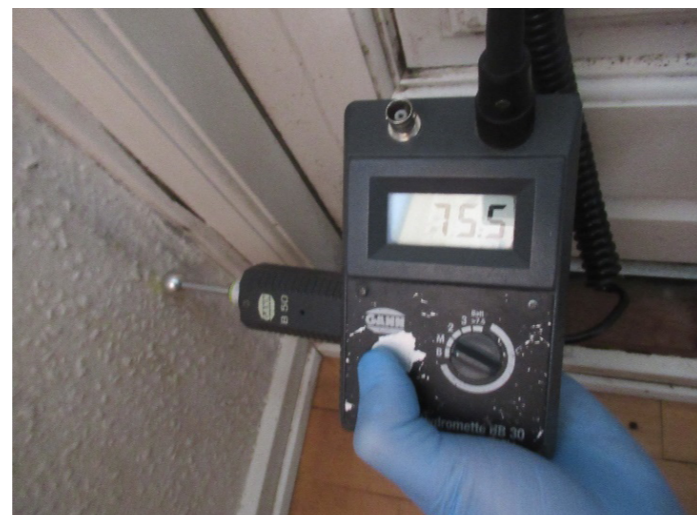
Eksempel på indvendig opfugtning grundet massiv kuldebro bag stålsøjle.
