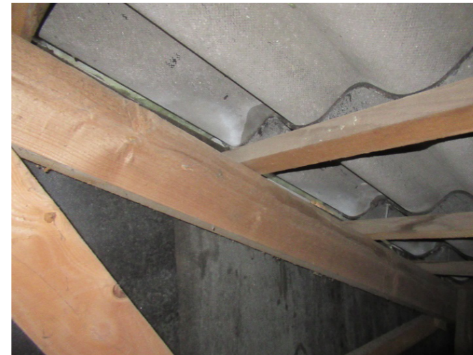
Bølgeplader med asbest – 52 år gl. – Eksempel på utætheder i samlinger – nr. 14
