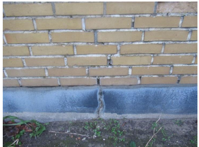
Eksempel på revne i sokkel i forbindelse med Bagvedliggende stålbæring for IPE-rem, mod syd i nr. 12.
