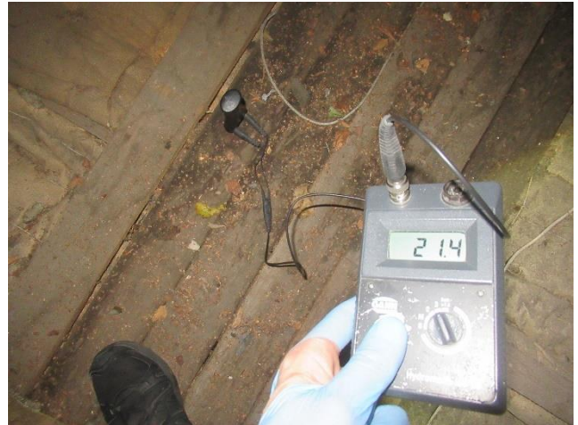
Eksempel på forhøjet træfugt i gangbro i tagrum i nr. 18.
