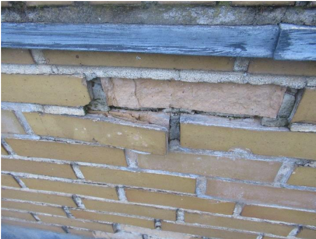
Eksempel på afskallet murværk i sydvendt facade i nr. 12.
