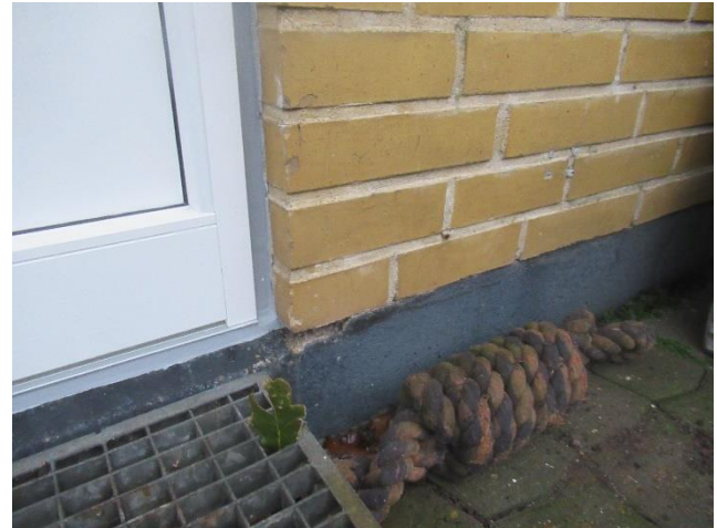
Eksempel på skadet sokkelpuds i overgangen til facadesten i nr. 16. Bemærk sokkelpuds der er ført ud forbi forkant facadesten.
