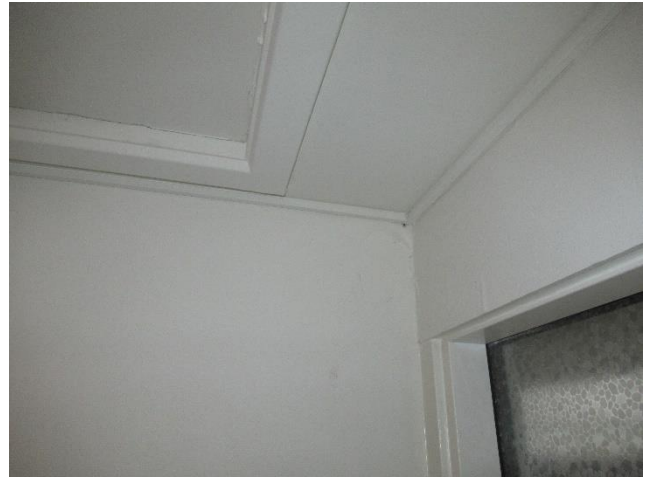
Eksempel på løst tapet i indvendig væg i overgangen til ydervæg i nr. 20
