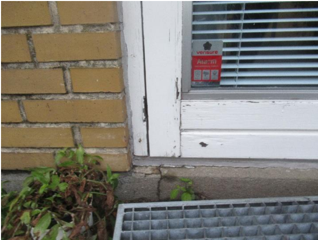
Revne/skade i sokkel i nr. 20, ved terrassedør.
