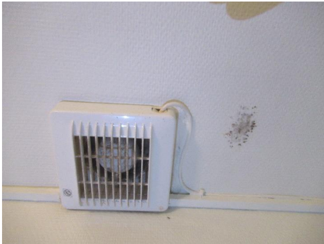
Eksempel på ventilering af toilet i nr. 13. Bemærk skimmelvækst på loft testet til en kategori B.
