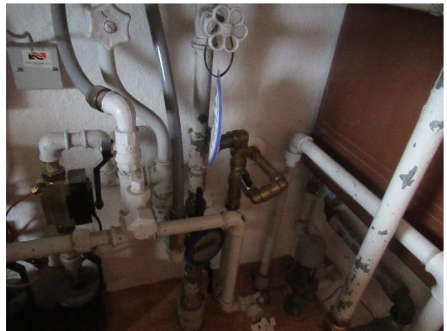
Eksempel på installation i nr. 13.
