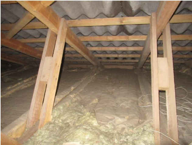
Eksempel på opfugtede/revnede tagplader i tagrummet i nr. 13.
