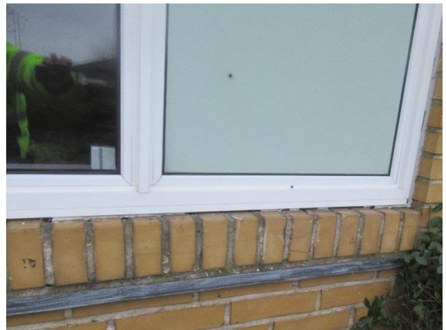
Eksempel på beskadiget/manglende elastiske fuger under vinduesparti i nr. 12. Bemærk forøgelses liste under vinduet.
