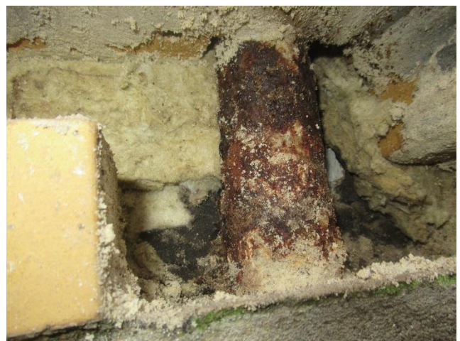
Korrosion i bærende søjle i brystning i nr. 13, sydvendt facade.
