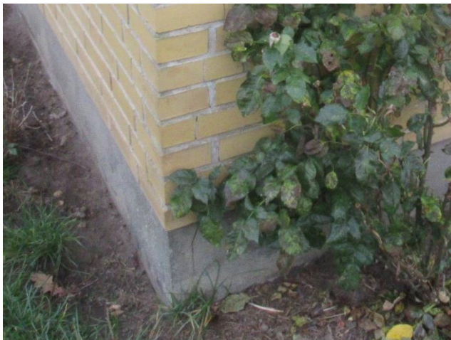
Eksempel på revne i kælderydervæg/sokkel i nr. 20. Revnen fortsætter lodret i facaden og vurderes at skyldes korrosion i bagvedliggende stålbæring for IPE-rem.
