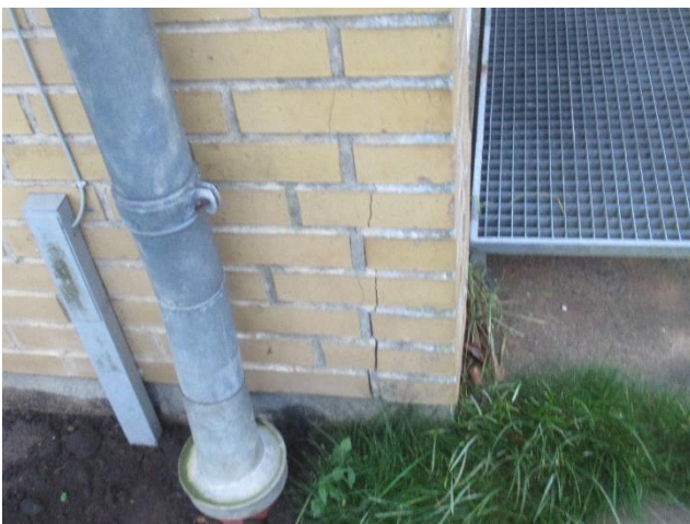
Eksempel på revne i facade ved udv. hjørne i nr. 20.
