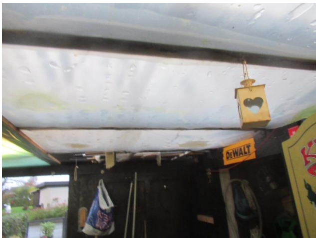
Utæt tagbelægning i carport ved nr. 18.
