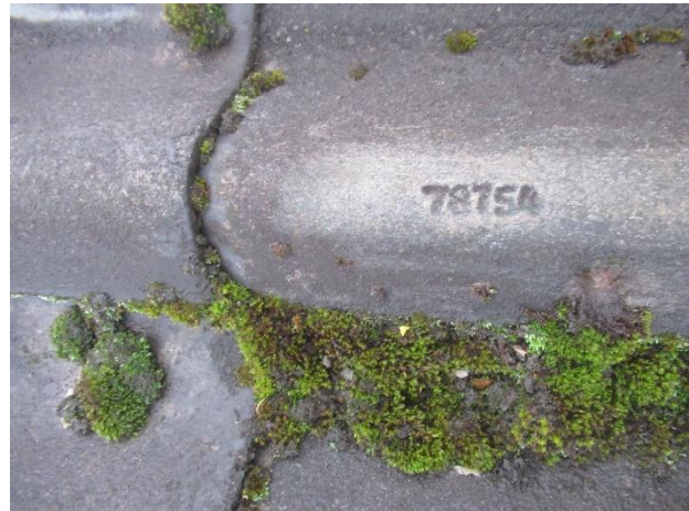
Eksempel på tagplade indeholdende asbest.
